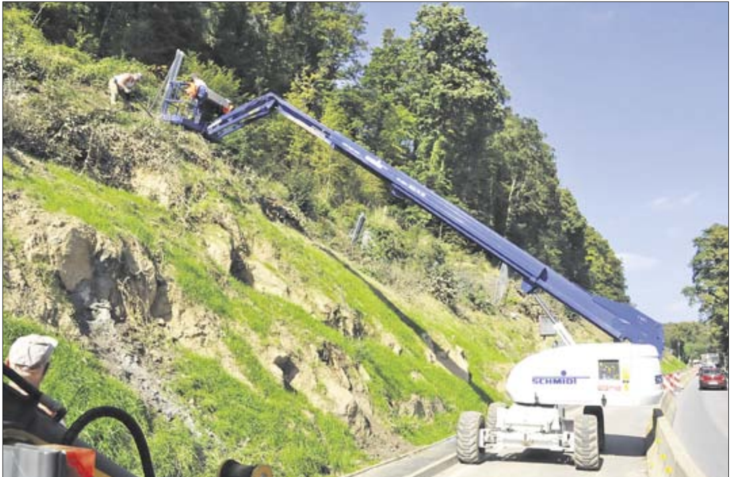
ZUR ABSICHERUNG des Schleiβberges an der Felsnase sind Arbeiter derzeit damit beschäftigt, über mehrere hundert Meter Pfosten in die Erde zu setzen und Zäune zu spannen. (Bild: Ralf Hellriegel)
